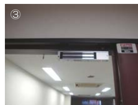
③ スチールドア枠に電磁石錠 電磁石錠はドア枠に取り付けるので扉内配線が無いので工事が楽です。
